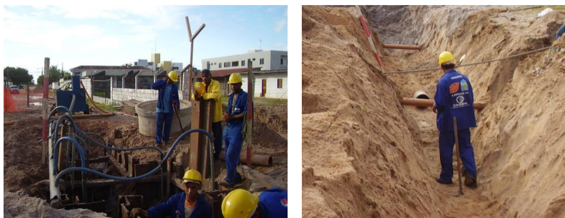
Figura 5. Serviços de esgotamento no bairro do Bessa com área plana e sem pavimentação
