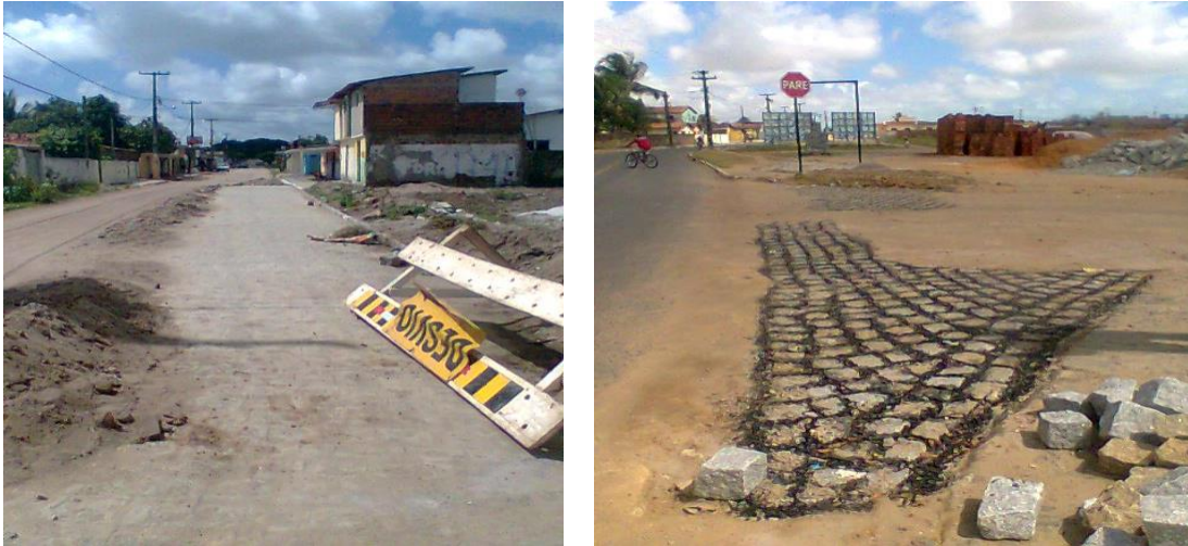
Figura 3 Transtornos ocasionados por ocasião da implantação das obras do sistema de esgotamento sanitários no bairro do Bessa, Zona Norte do município de João Pessoa-PB.
