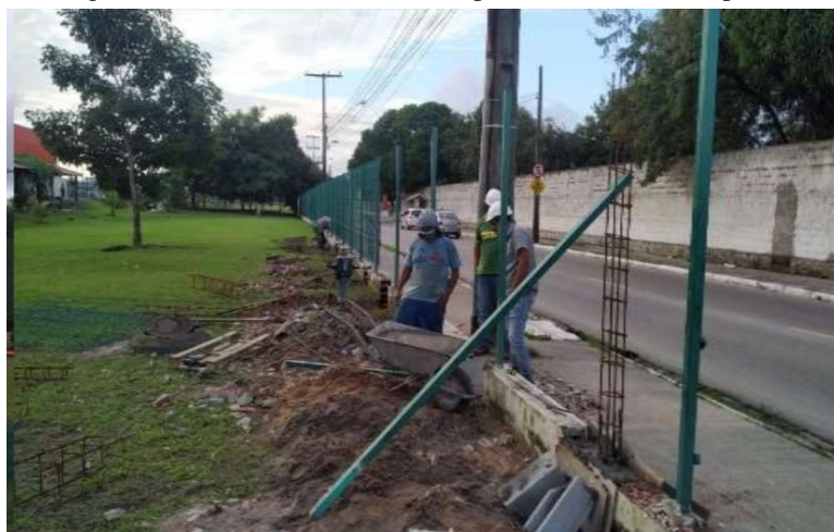
Figura 8: Engenheiro e mestre de obras da empresa C avaliando os próximos trechos
