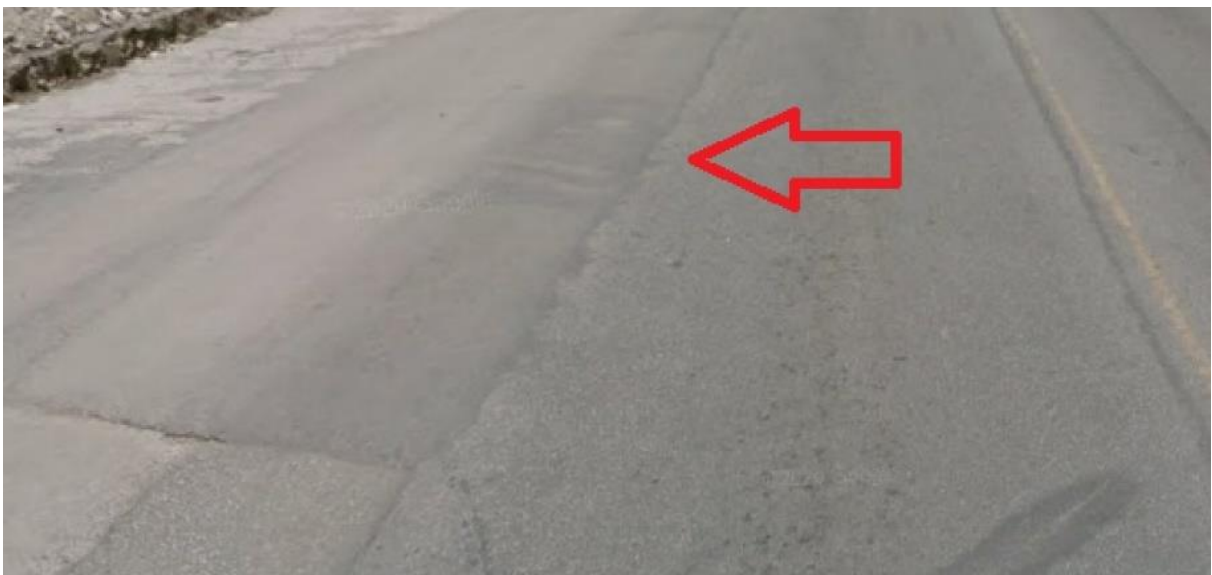
Figura 5: Conforme já comentado o remendo é considerado uma patologia quando mal executado, conforme mostra a figura acima.
