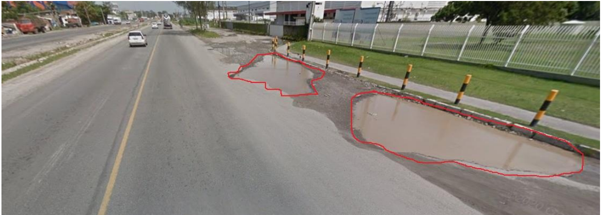
Figura 4: Rodovia BR 101 sul localizada na região metropolitana de Recife-PE, onde pode ser observada a existências de Panelas no pavimento, se estendendo para a rodovia de pavimento flexível.
