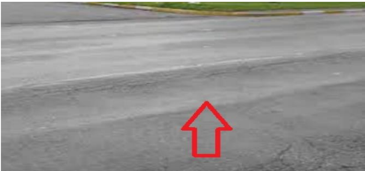
Figura 7: Afundamento visivelmente crítico ao longo do trecho da Br.
