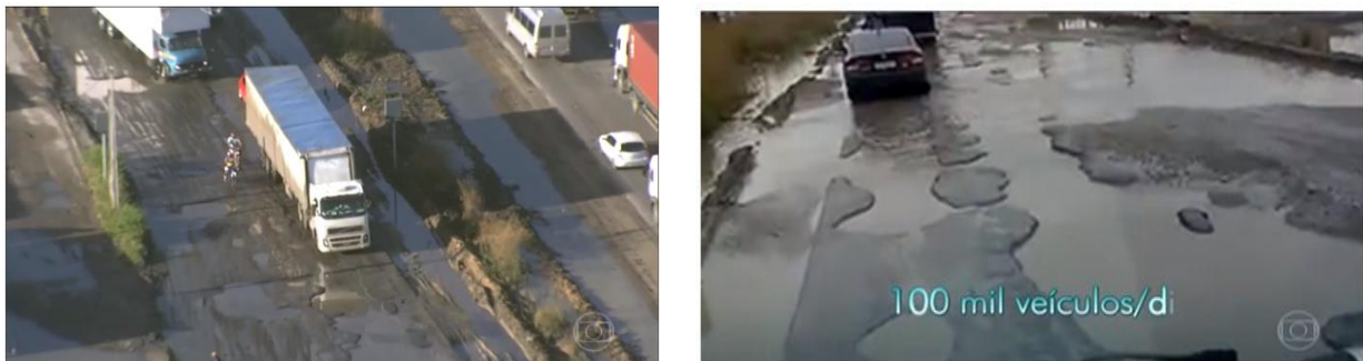
Figura 3. Trecho (km 80) da rodovia BR 101 sul, apresentando patologia em sua estrutura do tipo panela (buracos), ocasionando transtornos aos usuários.
