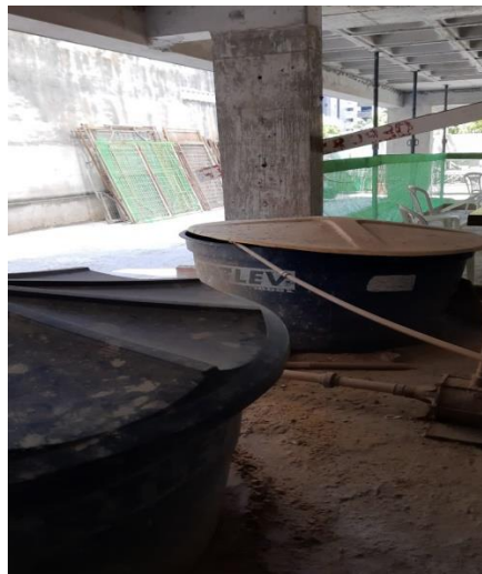
Figura 13 – Reservatório de água Fonte: Arquivo pessoal dos autores
