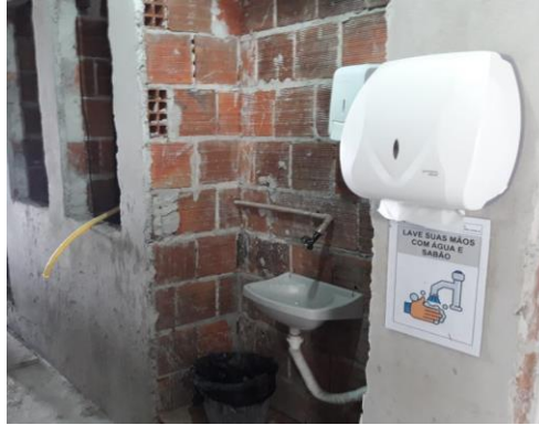
Figura 3 - Pia colocada em cada pavimento
